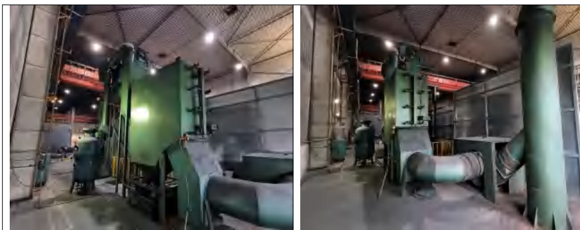
现有项目抛丸废气布袋除尘装置
