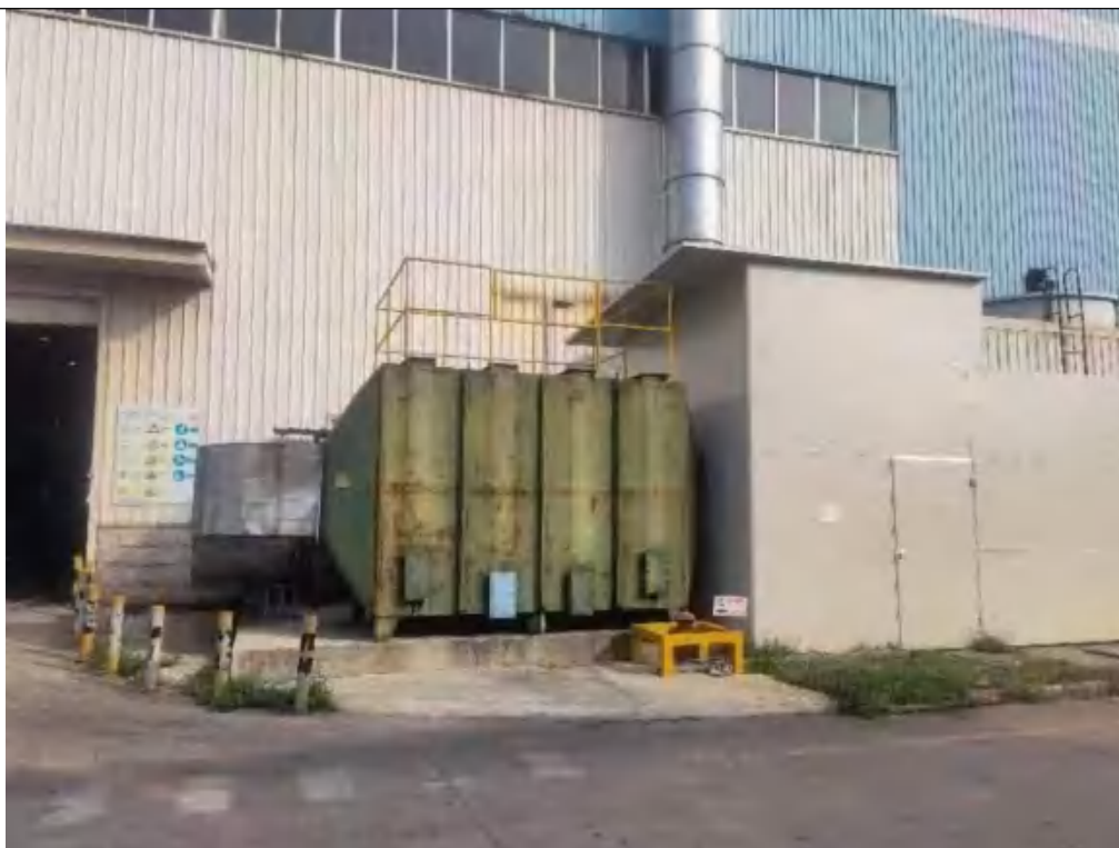
现有项目喷漆房废气处理装置
